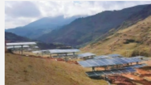
▶ 村级光伏扶贫电站
